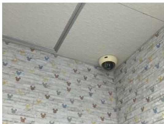
シングルタイプ風除室内防犯カメラ
